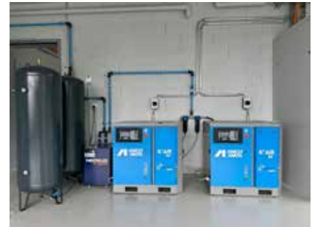
Local compresseurs Lokale Kompressoren
