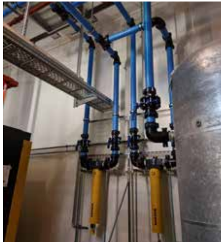
Réseau d'air comprimé Druckluftnetz
