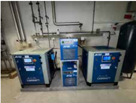
Local compresseurs Lokale Kompressoren
